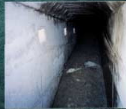
黒部峡谷歩道橋被災状況
