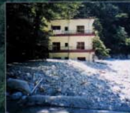
樺平地区の宿泊施設被災状況
