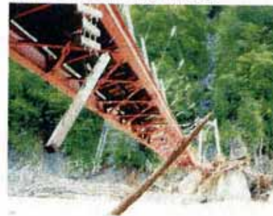
流木被害を受けたダムサイト人造橋 (写真提供/宮崎開発建設部)
