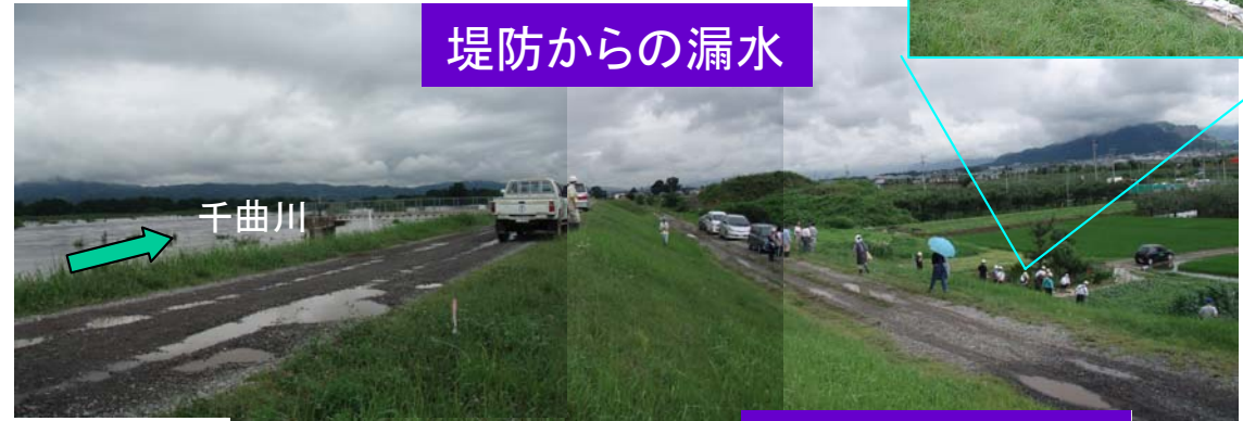
平成18年7月梅雨前線出水 漏水箇所 (千曲川:長野県 須坂市村山地先)
