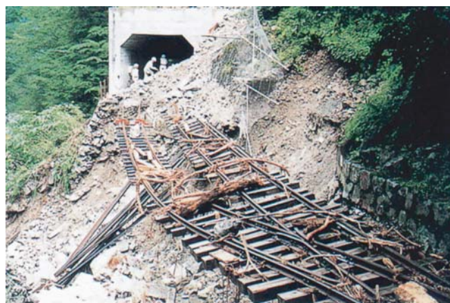
黒部峡谷鉄道被災状況
