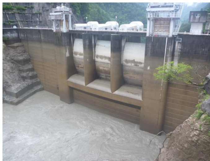
出し平ダム排砂路呑口部(13:15 水位低下中 貯水位:EL309. 0mm付近)
