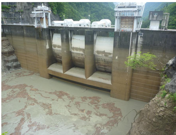
出し平ダム排砂路呑口部(12:25 水位低下中 貯水位:EL316. 0m付近)
