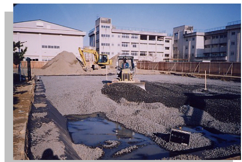
学校での雨水浸透施設例
