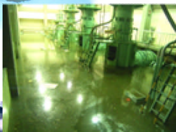
浸水した金沢市のポンプ場
