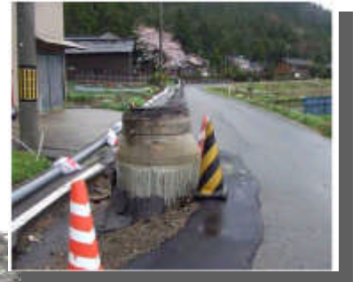
マンホールの浮上 (石川県能登半島地震)
