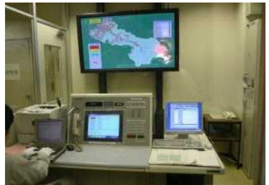
▲ 整備された防災通信施設
