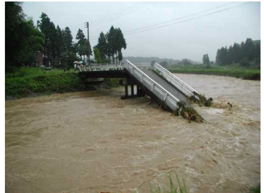
▲ 濁流により落橋した栄雲寺橋
