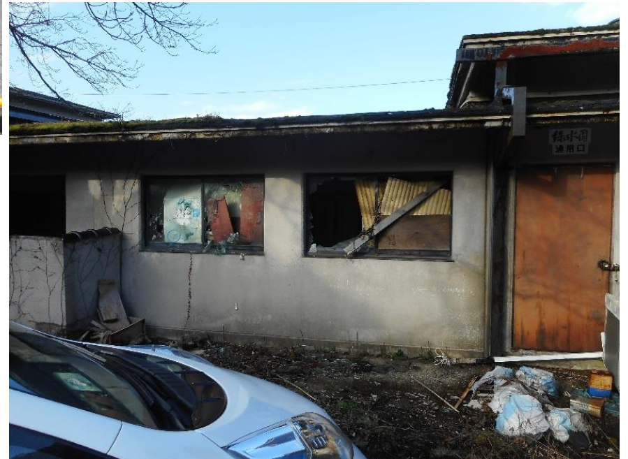
南側窓破損状況
