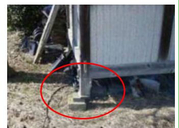
ランク3 (柱と基礎がずれており、大規模修繕が必要)
