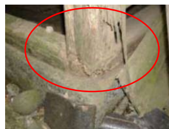
ランク3 (柱が腐朽しており、大規模修繕が必要)
