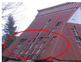
ランク3 (屋根に穴があいており、大規模修繕が必要)
