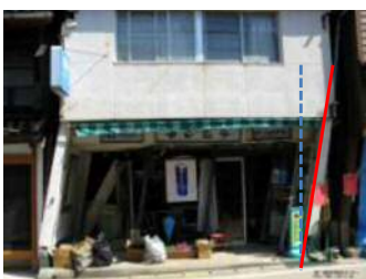
ランク4 (1/20以上の傾きがあり、再利用が極めて困難)
