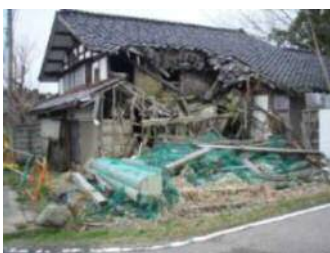
ランク4 (屋根が崩れており、再利用が極めて困難)
