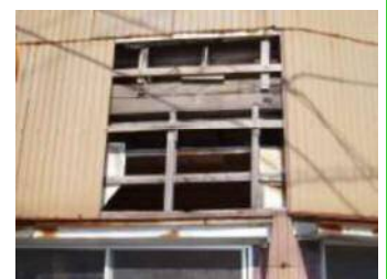
ランク3 (外壁がはがれており、大規模修繕が必要)
