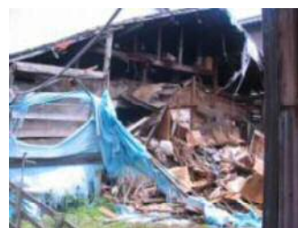
ランク4 (壁が崩れており、再利用が極めて困難)
