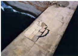
平成13年3月 護岸被災状況写真
