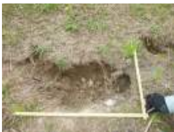
キツネの巣穴による堤防の損傷
