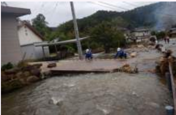
河川調査班による被災調査（長野県佐久市）
