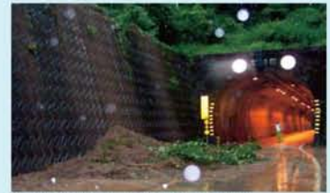
H17.7(七尾市)土砂災害の状況
