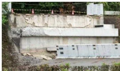
写真-2 横変位拘束構造の破壊、落橋(県道小川嘉島線・府領第一橋)
