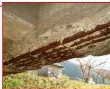
主桁の剥離、鉄筋露出
