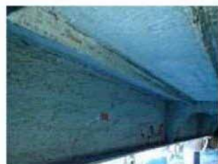
桁の塗装劣化やさびの発生
