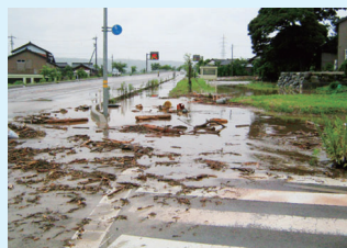
H20年7月8日 土石流発生状況 (羽咋市四柳町地先)
