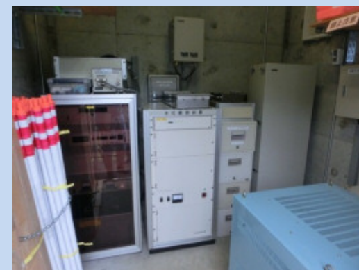
中島水位観測所の観測機器（手取川）
