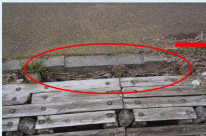
階段の木材欠損（梯川）
