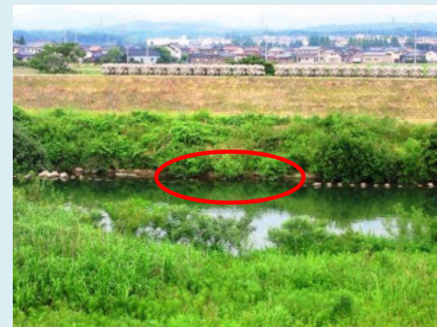
護岸沈下の発見（梯川）
