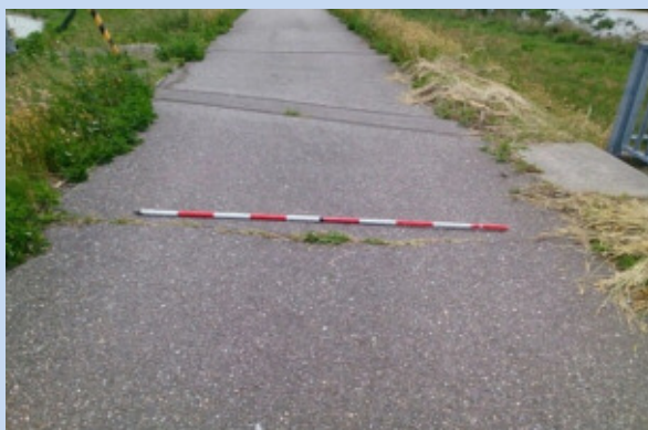
堤防道路の舗装クラックの確認（梯川）
