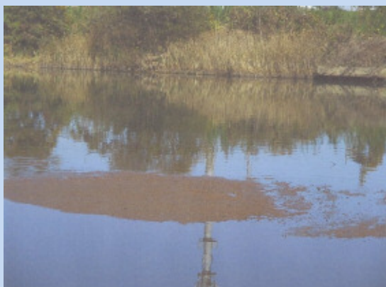
河川の状況に関する活動報告（梯川） 親水護岸そばの土砂堆積
