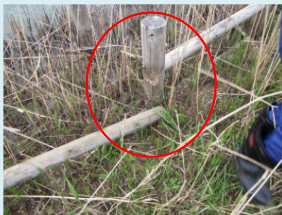
点検による木柵の破損確認（手取川）
