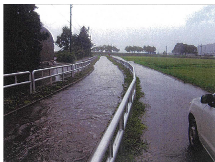
写真3-4 西部幹線水路の大雨時の状況
