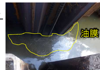
写真② 掘削面から湧出した油
