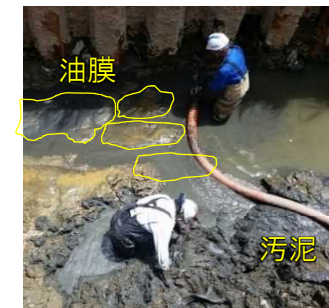
写真② 旧河道の河床から湧出した油と旧河道内に堆積していた汚泥
