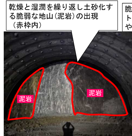
図3-2 脆弱な地山(泥岩)の出現 おおいわがわ (大岩川トンネル)
