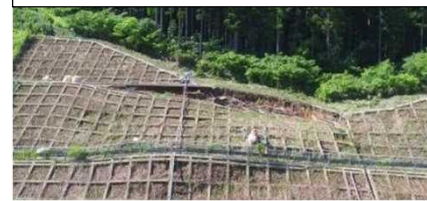
写真3-4 村上瀨波温泉ICの斜面崩壊
