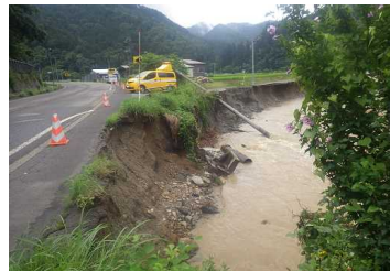
写真② 大雨による護岸崩壊 かみおとり (村上市上大鳥 R4. 8. 4)
