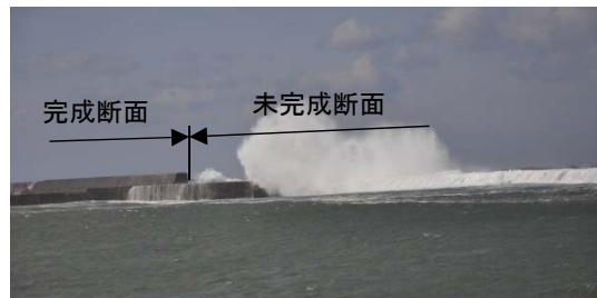
写真2-2 未完成断面の越波状況 (撮影：平成28年11月)
