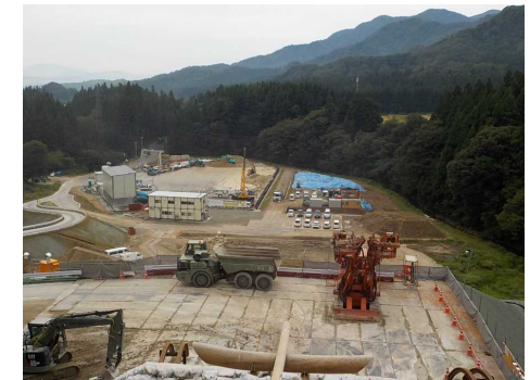
写真① 朝日温海道路の整備状況 トンネル部に設置した建設機械 大須戸第二IC付近から新潟市方面を望む (H29. 10. 1撮影)
