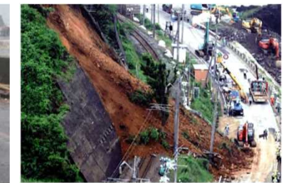
写真⑤ 法面崩落による通行止め （鶴岡市小岩川地区 H18. 7. 13）
