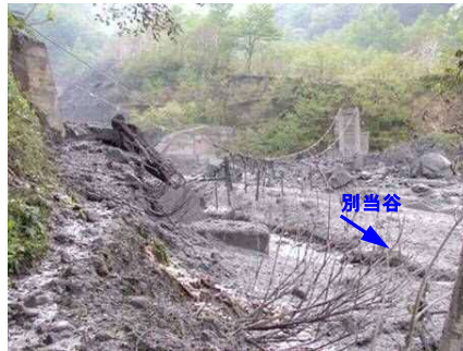
べっとうだに 別当谷の吊橋流出状況
