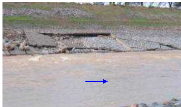
堤防護岸被災及び根固流出
