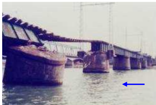
落橋した加越能鉄道庄川橋梁
