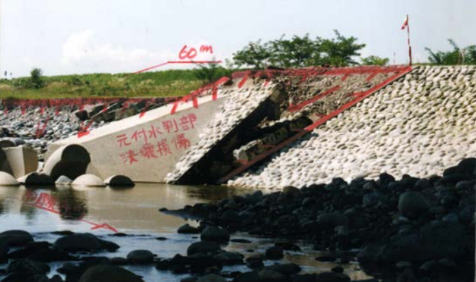
河床の局所洗掘により傾く水制工（左岸10.6K）
