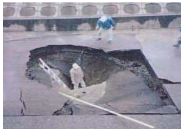
護岸背後の陥没状況
