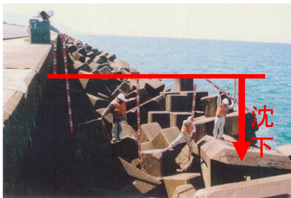
消波ブロックの飛散・沈下状況
