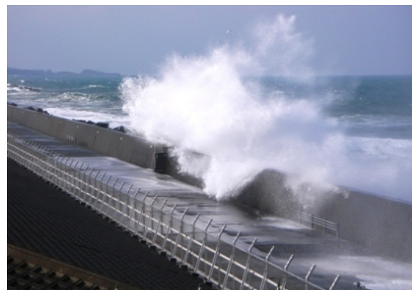
護岸の越波状況 ②
