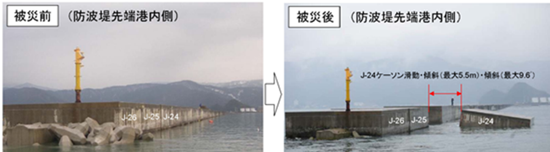
写真2-1 平成24年4月 鞠山防波堤被災状況(J-24)
