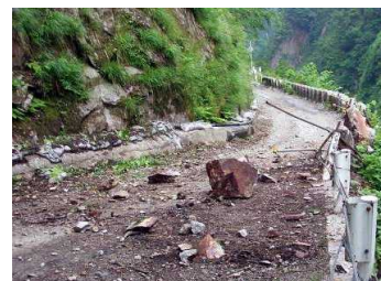
資材運搬道路での落石状況
