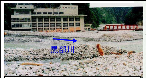
土砂流出・堆積により被災する黒部川第二発電所の状況 (H7災害)
