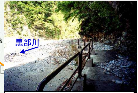
土砂で埋没した猿飛峡遊歩道
