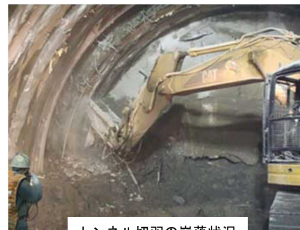
トンネル切羽の崩落状況
