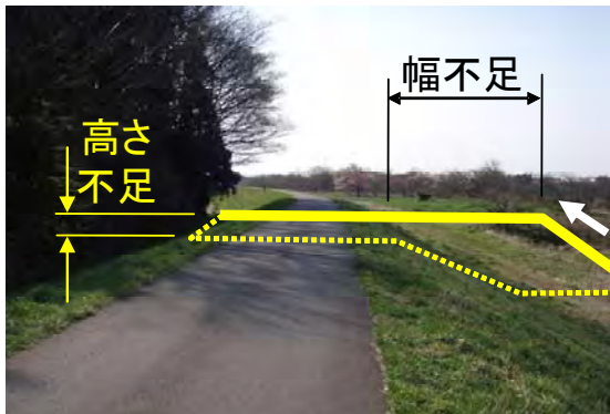
堤防幅が不足している区間(五泉市笹堀)
