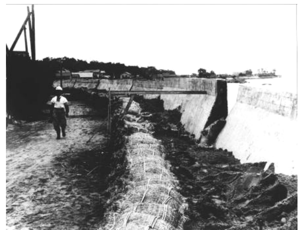
特殊堤被害状況
