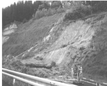
写真B：土砂崩落による通行止め (氷見市藪田)
