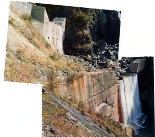
柳谷第3号砂防堰堤の亀裂(昭和54年) (上流は新甚之助第5号砂防堰堤)
