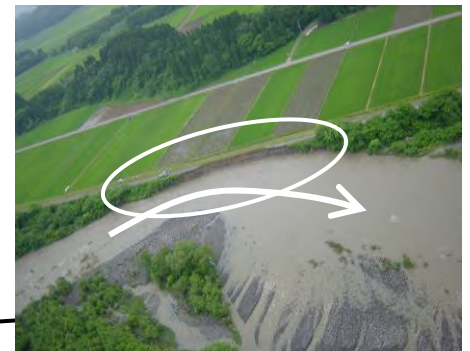
胎内川左岸堤防欠損(平成17年6月)
