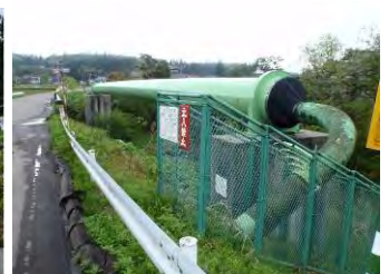
ガスパイプライン
