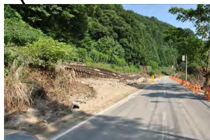
豪雨により磐越西線の鉄道盛土が流出(平成23年7月)
