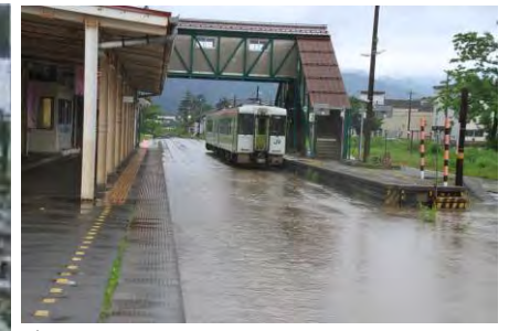
小国駅構内線路冠水(平成23年7月)
