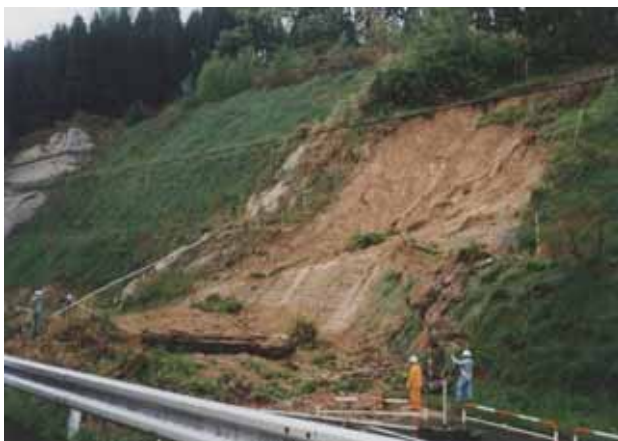
現道の状況：国道160号藪田地先の土砂災害(H3.6月)
