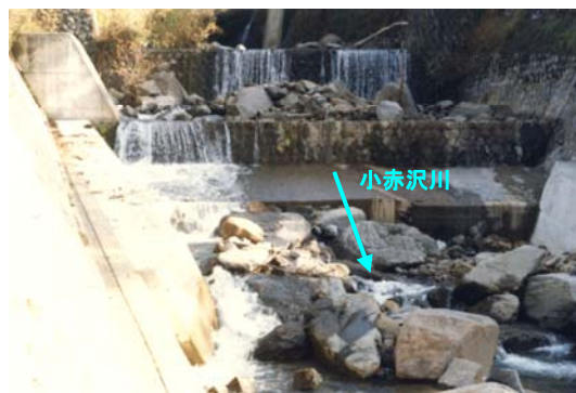
昭和56年8月台風15号により 土石流が流下した小赤沢えん堤群 (集落への被害は無かった)
