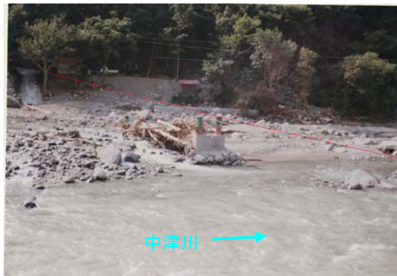
中流域に位置する秋山小学校下流のつり橋の流失状況(昭和57年8月2日)
