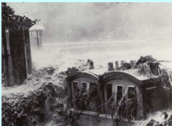
流出した愛本堰堤
