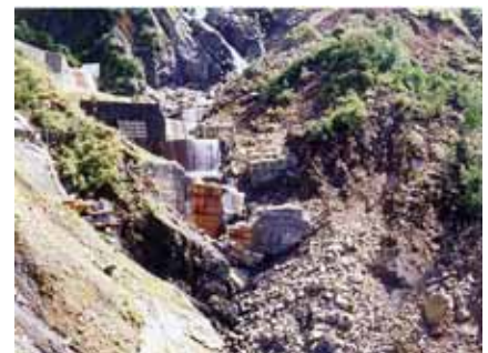
平成4年の出水による柳谷第3号、6号砂防堰堤の被災状況
