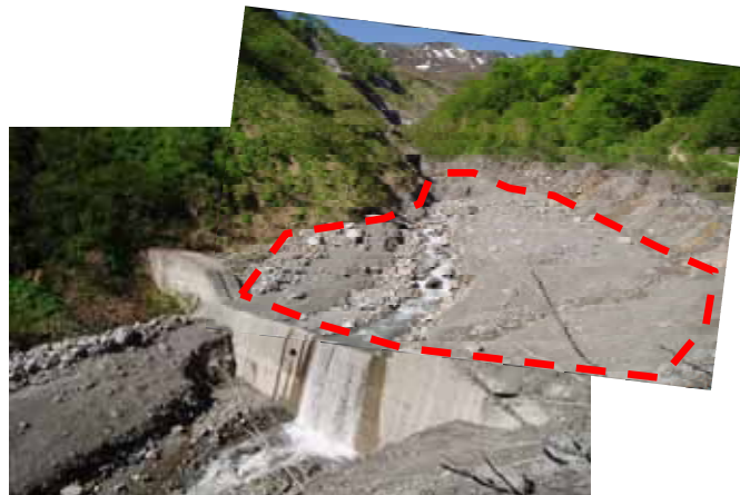
土石流を捕捉した別当谷21号砂防堰堤
