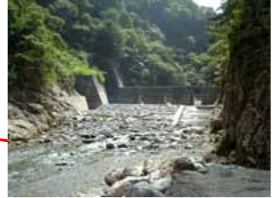
尾添川からの土砂を流出させる 大暗渠を設けた 尾添川第1号砂防堰堤
