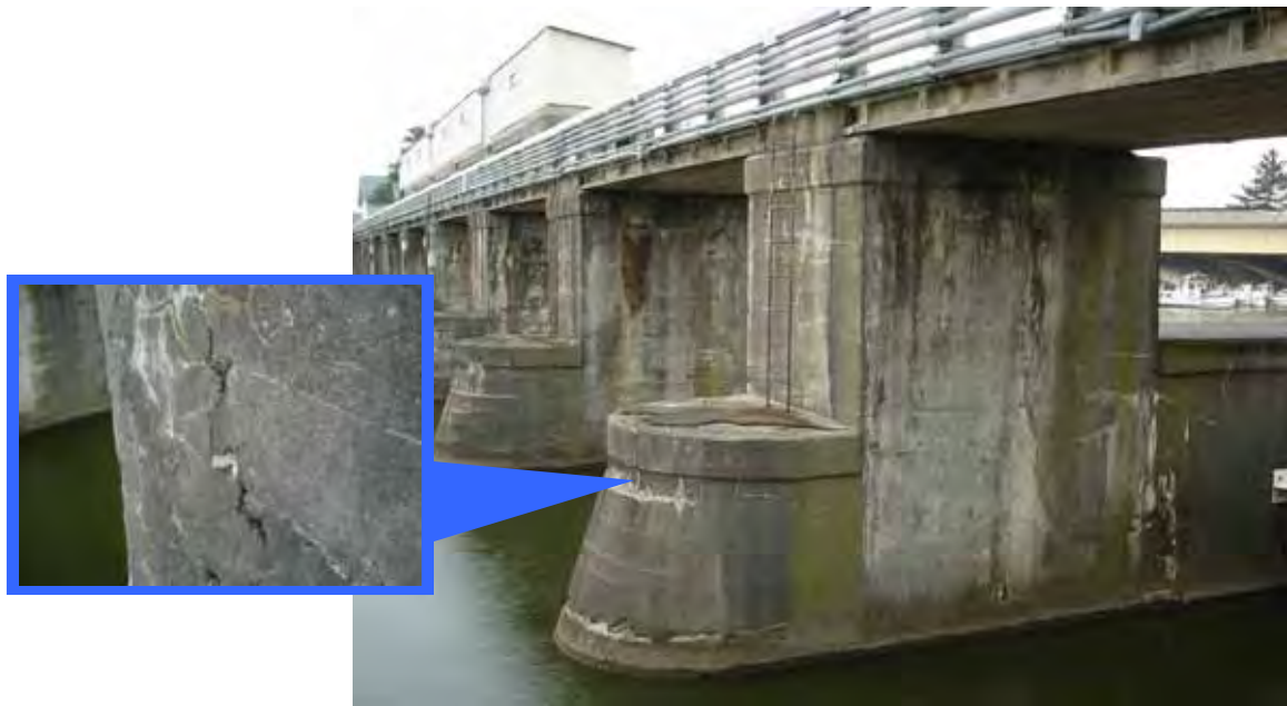
コンクリートの劣化等が進んでいる
