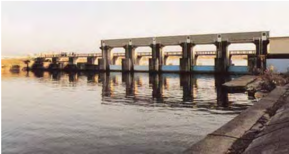
昭和7年に設置され老朽化がすすむ梯川逆水門
