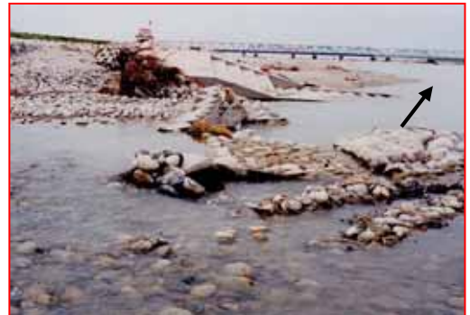
洪水流により護岸流失
