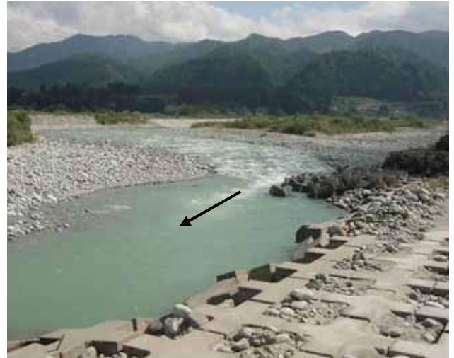
河床洗掘により根固が沈下
