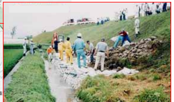
漏水による水防活動
