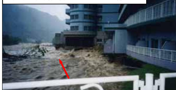
平成10年9月災害 マンション基礎部決壊
