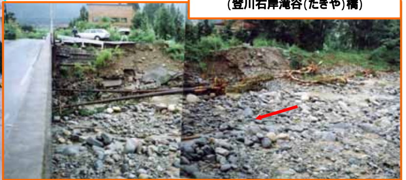
S58.8災害 土砂の堆積、護岸破損状況 (登川右岸滝谷(たきや)橋)
