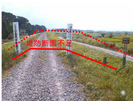
堤防断面不足
