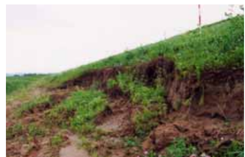
堤防の質的整備(法崩れ) (平成14年7月出水)
