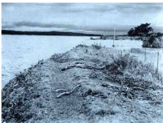
阿賀川右岸 決壊した堤防 (会津若松市飯寺地区)
