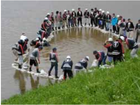
水防活動（湛水・漏水部） （会津坂下町広瀬地先）
