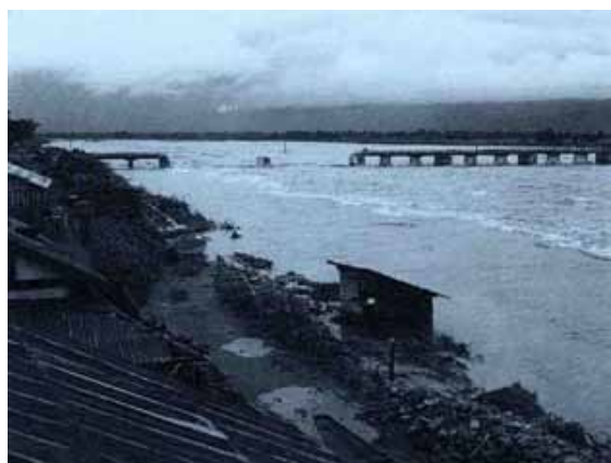
阿賀川左岸流出した宮古橋 (国道 49 号線)
