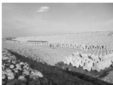
図3-5 水制工と現場発生したブロックの再配置による水中カバーの創出
