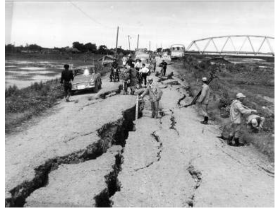
堤防被害状況 (左岸 1.0km, 新潟市東区下山)
