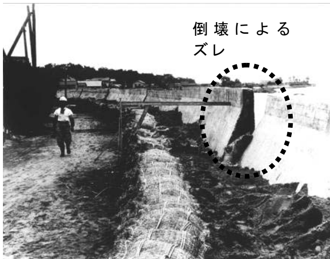
特殊堤被害状況 (右岸 0.0km, 新潟市北区松浜)
