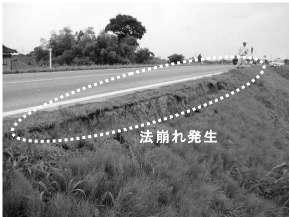
浸透による法崩れ
