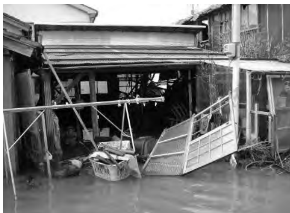
浸水による家屋の被災状況
