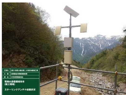
現場用スターリンク設置状況
