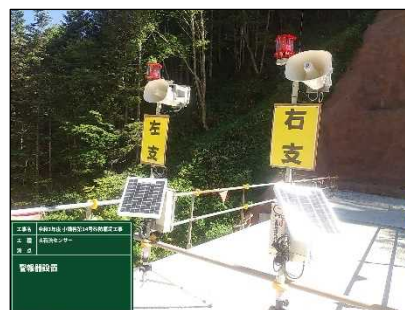
警報機設置状況
