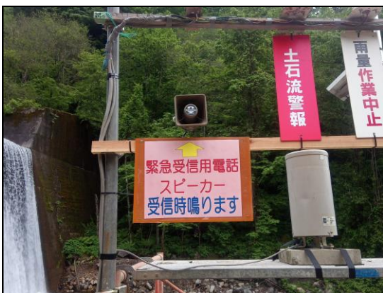
【スピーカー設置状況】
