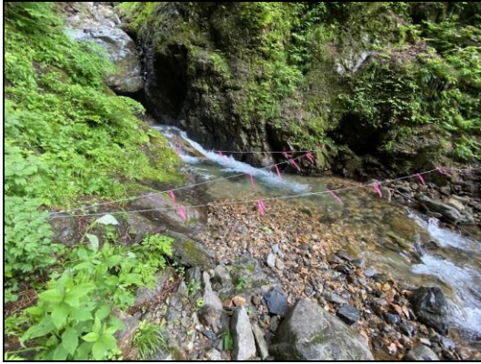
【上流土石流センサー設置状況】
