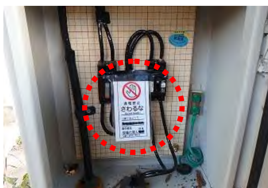
<操作禁止札取付状況>
