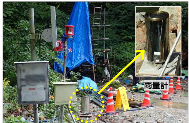
調査地に設置した雨量計、警報機器(無線式)
