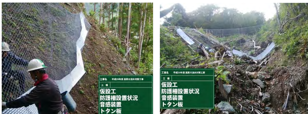
【写真－4 落石防護柵】
