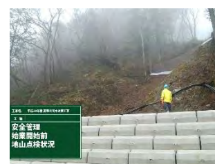
【写真-7 崩壊地点検】
